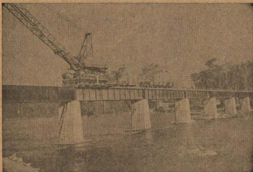
Outra vista da ponte sôbre o Amapari, vendo-se o guindaste de lançamento das vigas
