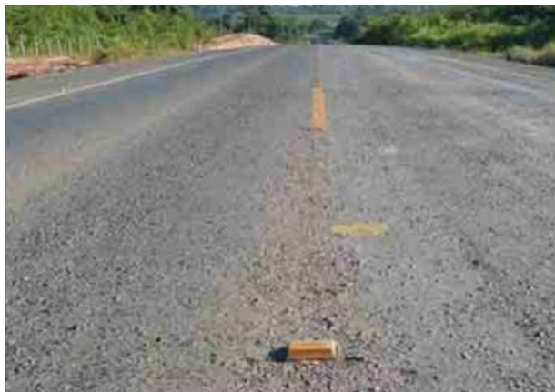
Fig. 4 – Detalhe da superfície do segmento da BR-163 construído com argila calcinada em 2009 após dois anos de uso[13].
