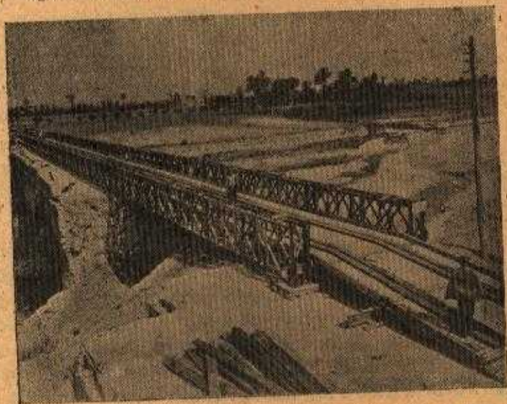
Atividades da nossa engenharia — Ponte tipo Bailey (26 pés, D.S., contínua em 4 lances, classe 40), construída sobre o Rio Pó, nas imediações da Piacenza.
